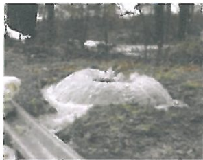
Desbordamiento de boca de alcantarilla
