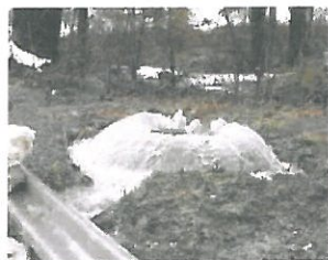
Desbordamiento de boca de alcantarilla
